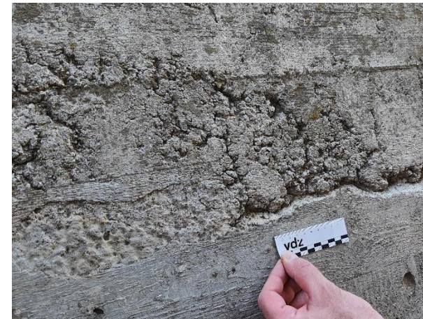
Verdichtungsprobleme an einem Bauteil von Brücke 3
